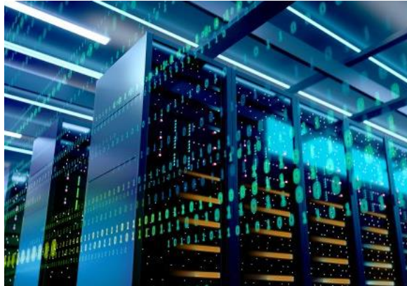
DATA CENTER AI
