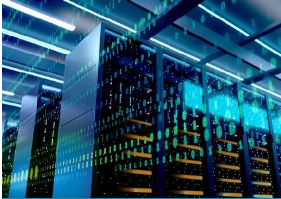
DATA CENTER AI
